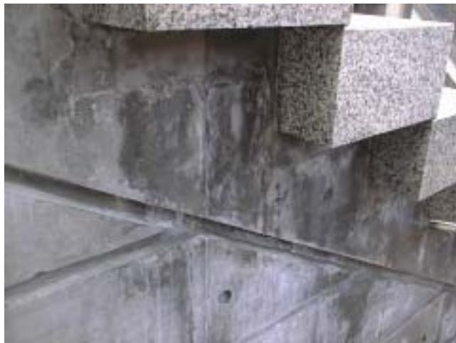
翌朝、クラックよりまだ水漏れしている。
