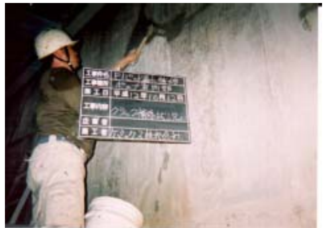
クラック補修
